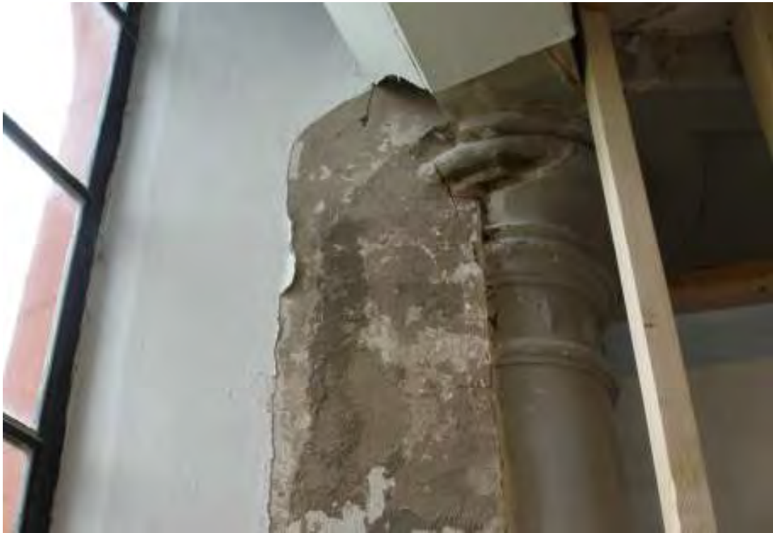
Spår efter äldre färgsättning, kvadermålning i en mörkt röd färg på gråbrun botten, framkom på flera ställen, här i norra fönstervalvet.
