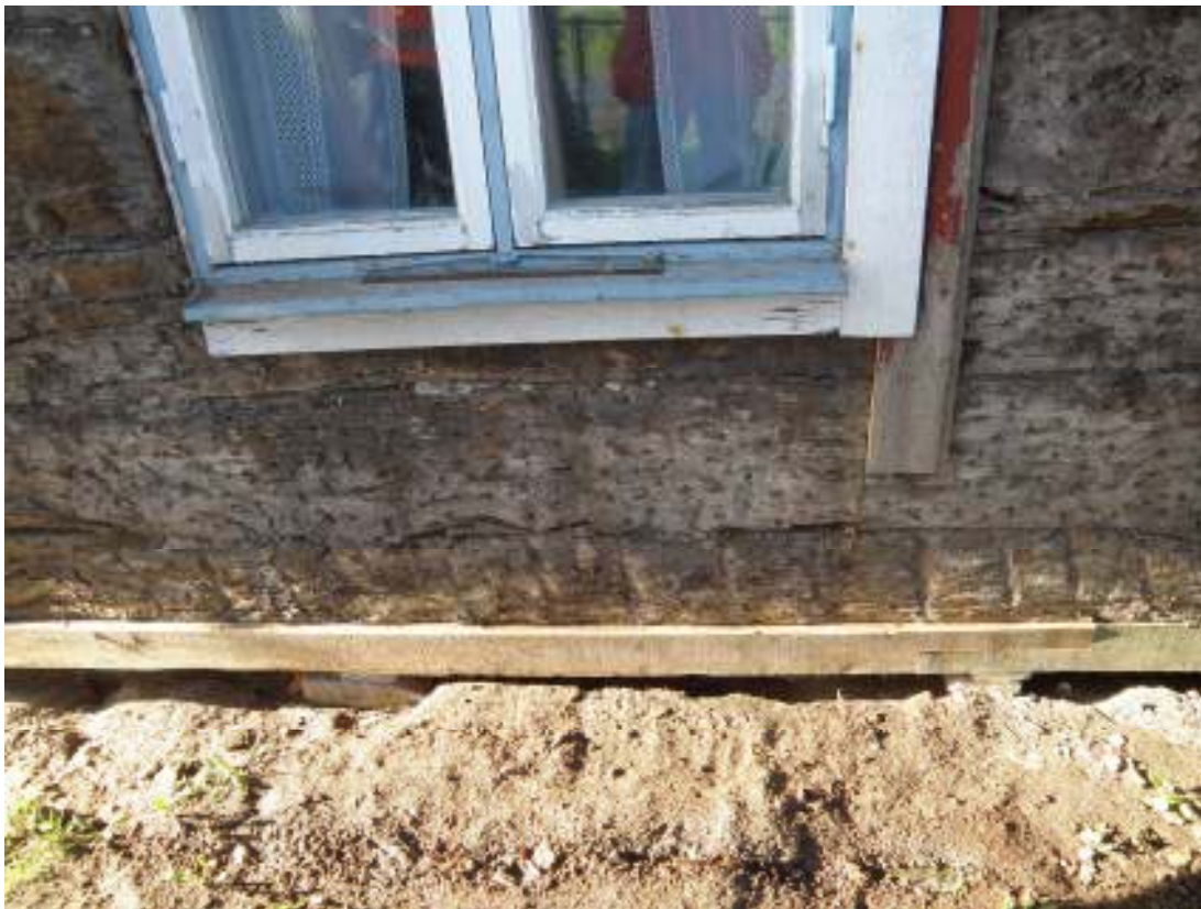
Fönster nr 6. Väggtimret har varit "pliggat" för att bättre hålla putsen. Fotträet bytt.
