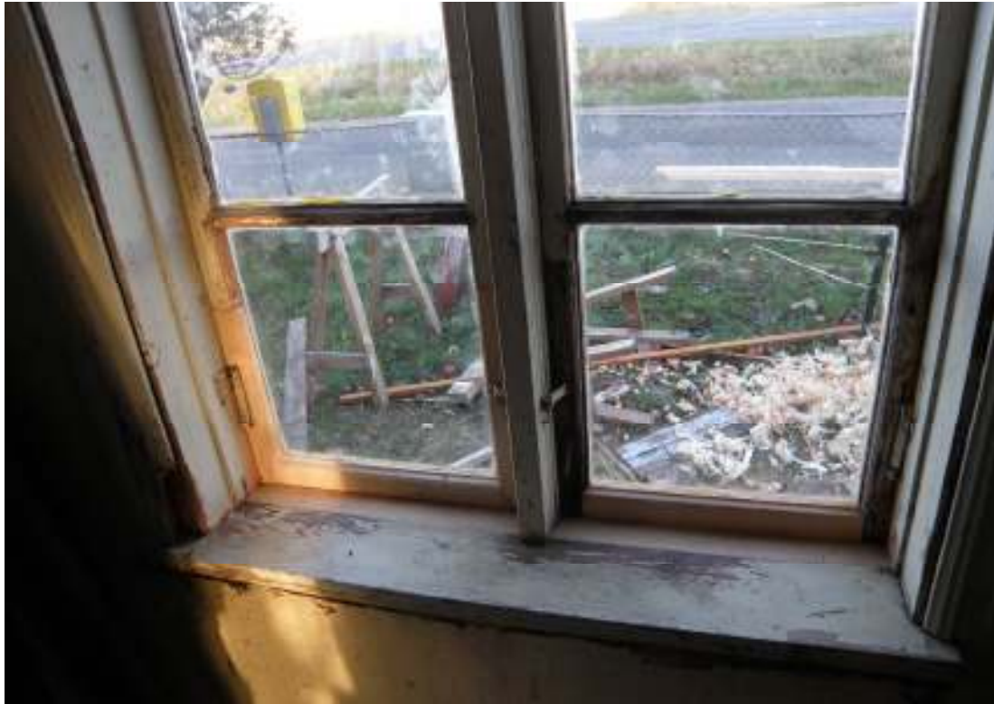
Fönster nr 9. Exempel på lagningar i karm och på bångar.
