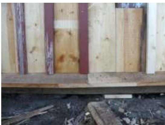
Östra fasadens vattbräda. Notera skarven.
