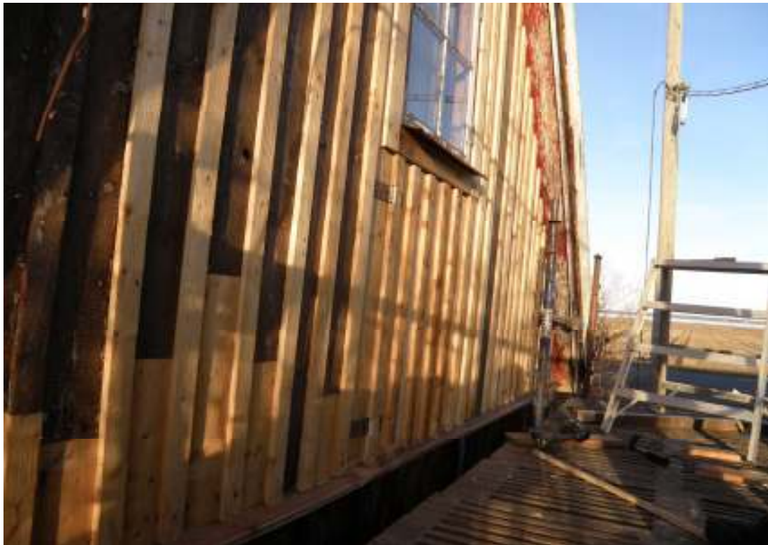
Södra gavelröset. Omfattningen av bytt panel. Notera luckan.
