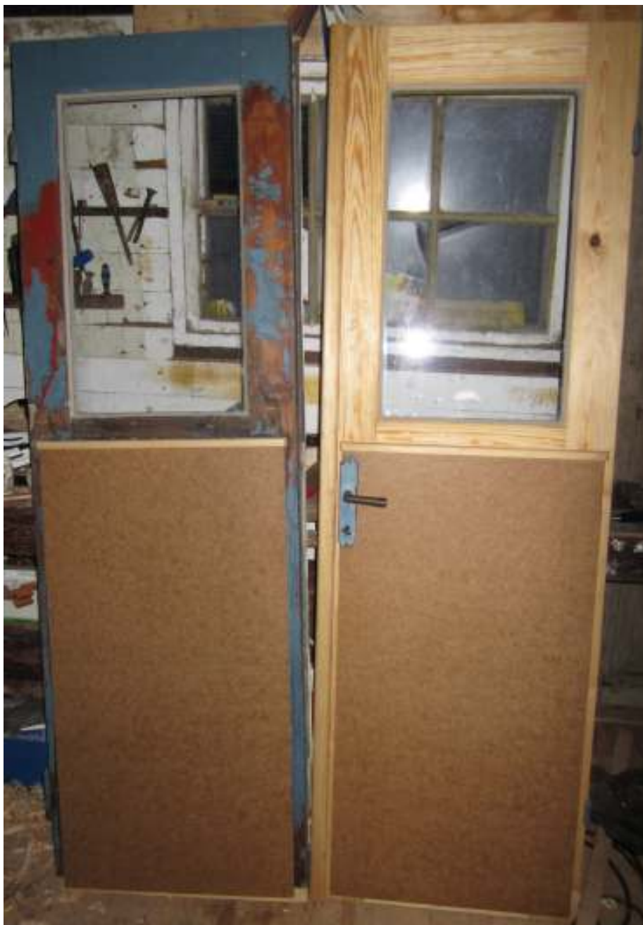
Restaurerat respektive nytillverkat dörrblad till östra fasadens entré. För placering se Bilaga 1. Foto Karl-Magnus Melin, 2011.
