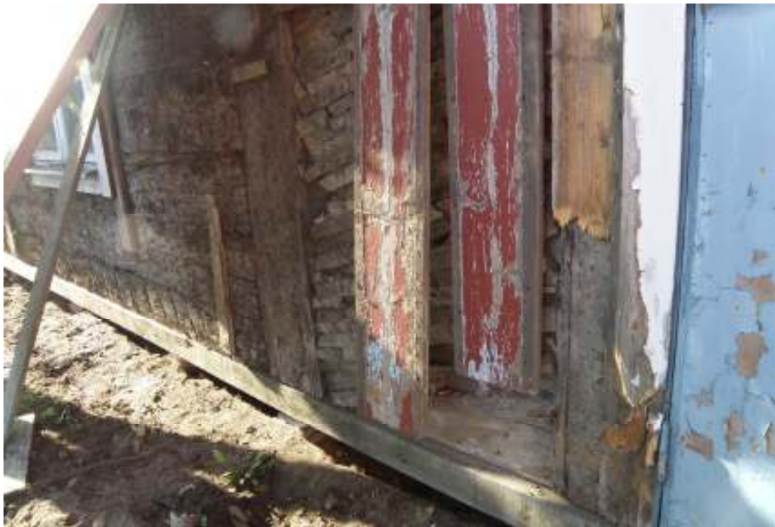
Panelbrädorna undanlyfta. Spräckpanelen med vidhängande putsfragment synlig.
