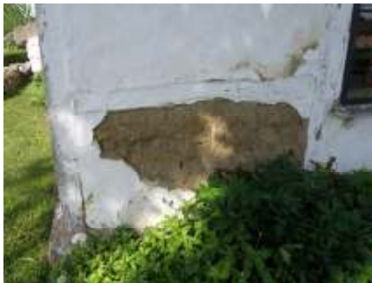
Fig. 5. Skadat lerstensfack på boningsdelen.
