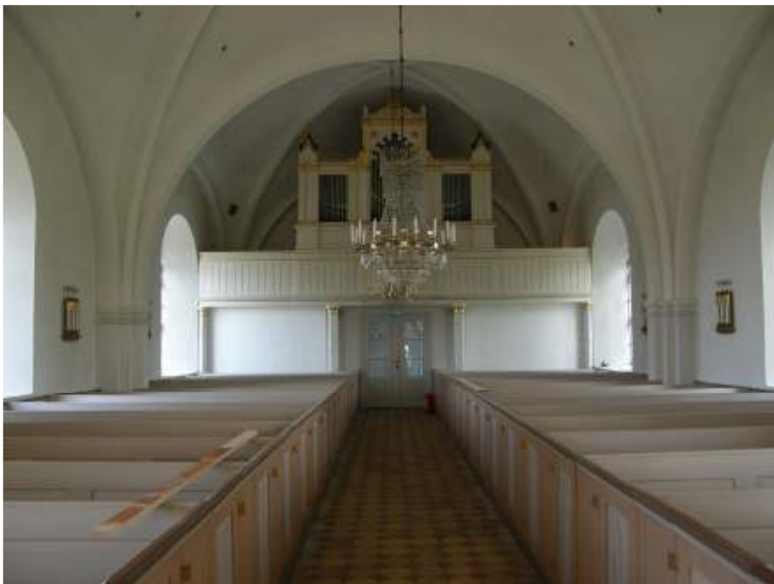
Långhuset sett mot väster efter ombyggnad. Dörren har flyttats österut till det nya väggpartiet.
