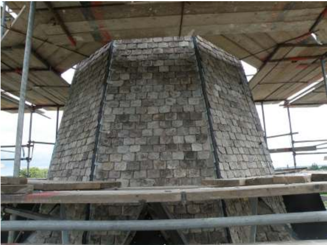
Den nya skiffertäckningen under arbetet. Mellan nockarna och skifferplattorna är inskottsplåtar instuckna. Nockplåtarna återstår att monteras.
