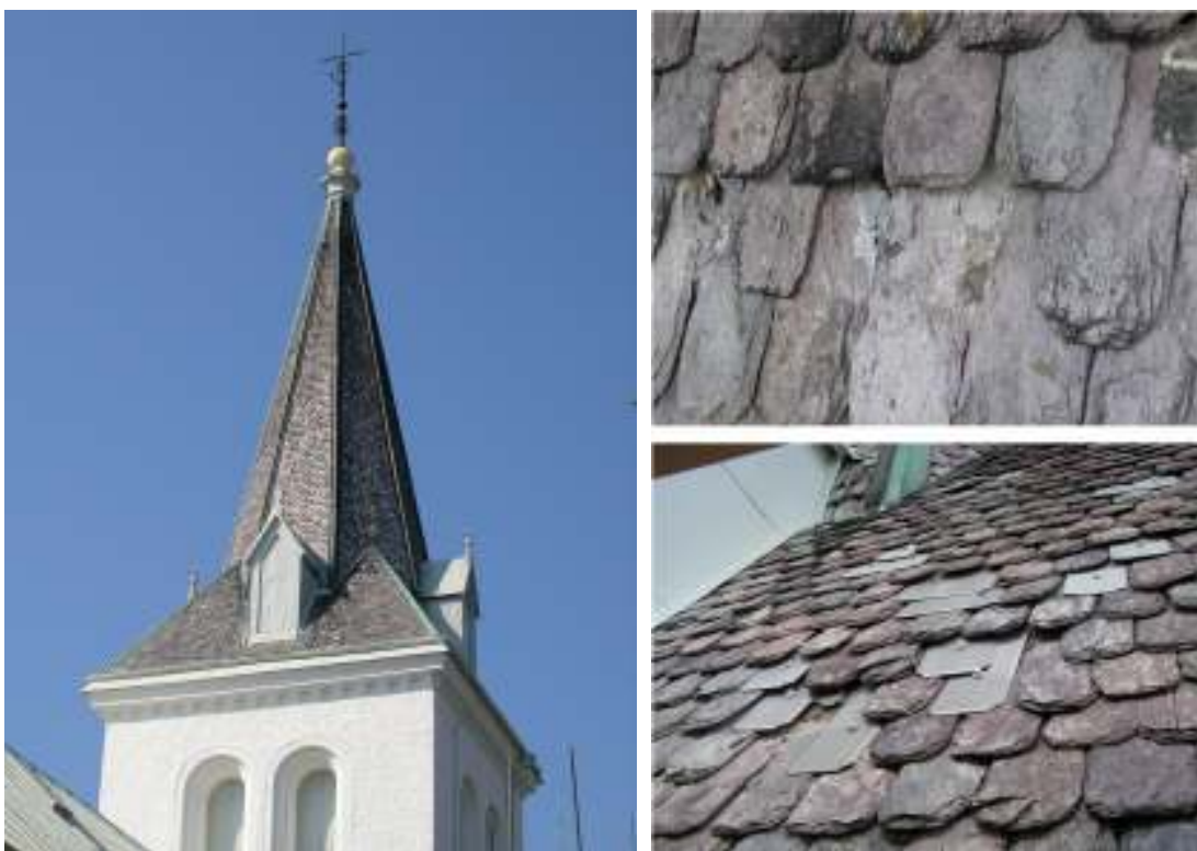
Tornspiran före renoveringen med detaljbilder på den skadade skiffertäckningen. Skifferplattorna har spruckit och delvis lagats med bruk. Provisoriska lagningar av plätinskott har utförts där plattorna har ramlat bort.
