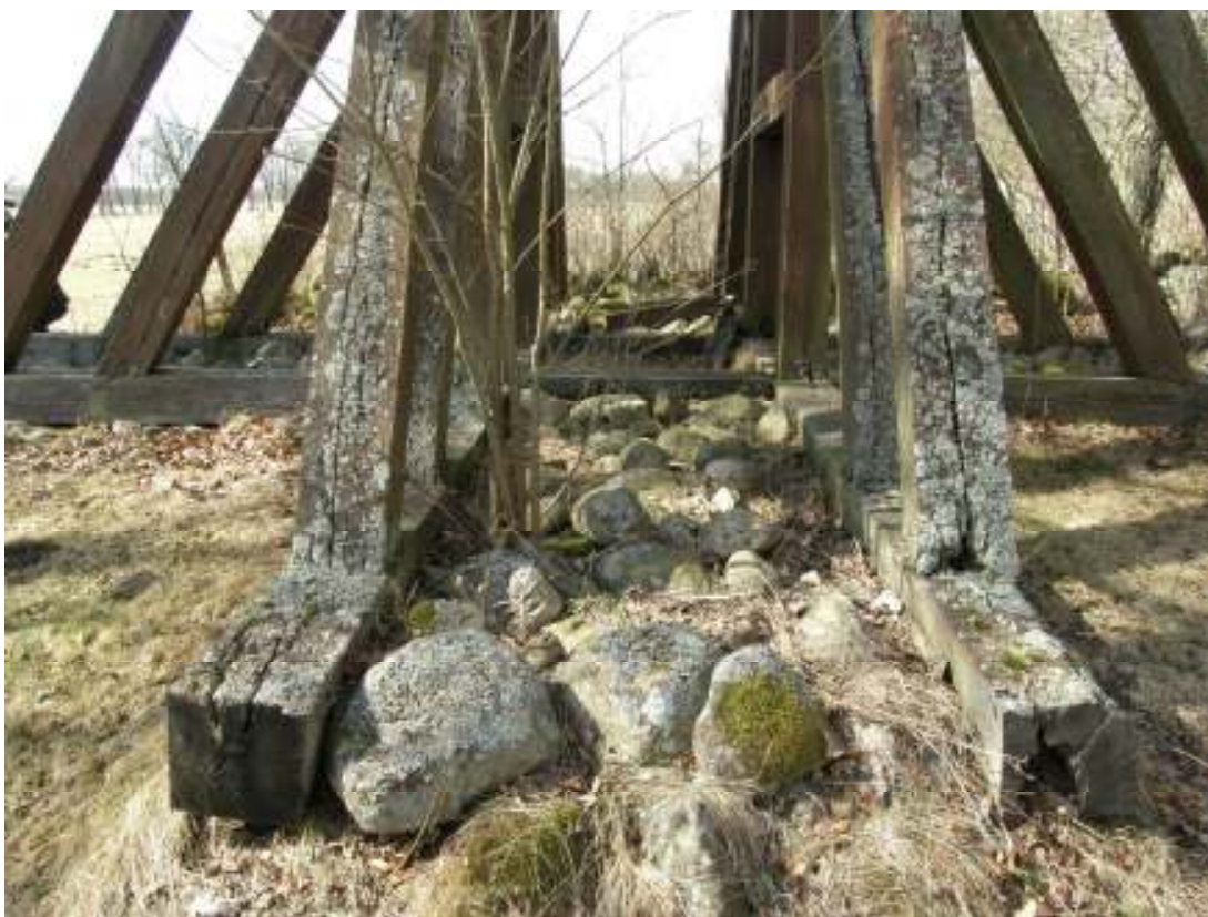
Exempel på rötskador i fotträ och snedsträvor samt sprickbildningen, östra sidan.
