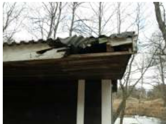
Mekanisk skada i takfoten.
