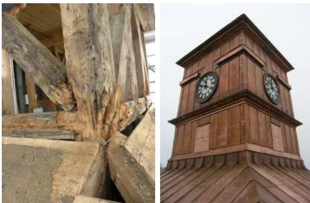
Foto 5 och 6. Rötskador i lanterninens stomme och färdigklädd lanternin.
