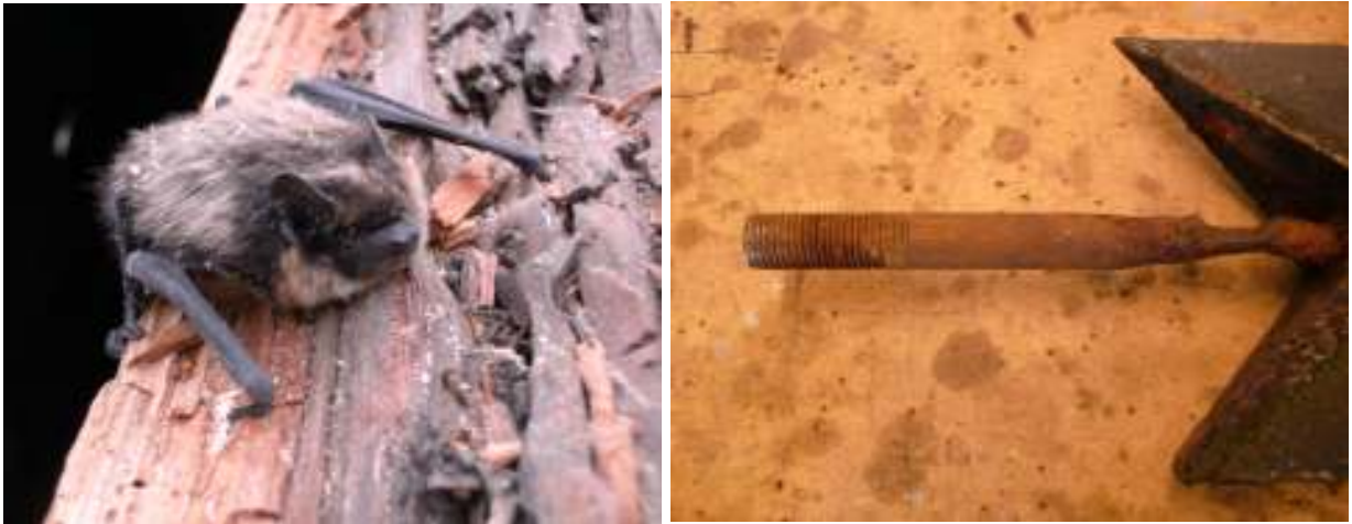
Foto 15 och 16. Fladdermusbesök på rötskadat korsarmstak och rostangrepp på korkors.
