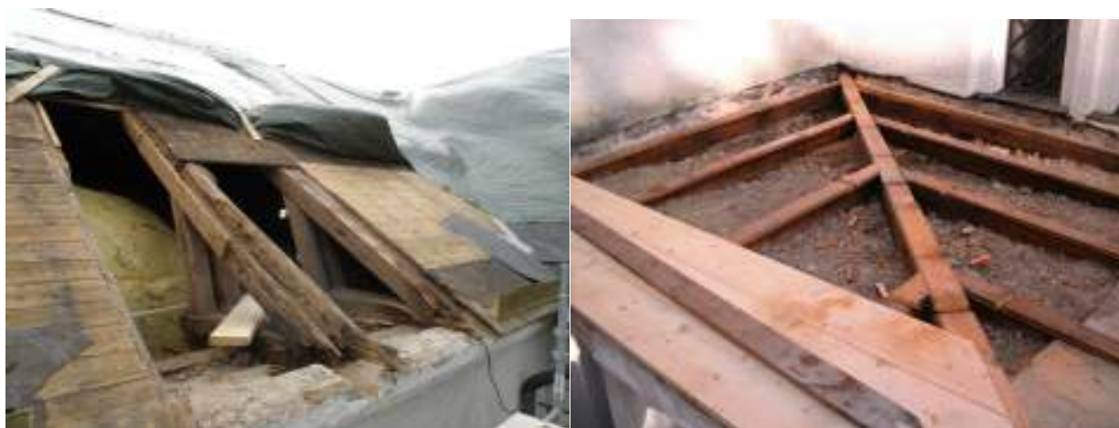
Foto 9 och 10. Rötskador vid norra korsarmens västra takfot och omläggning av sakristians tak.
