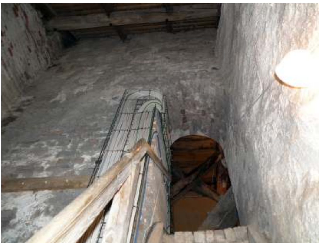
Södra tornväggen sett från söder och ingången till tornet. Murverket mot söder är oregelbundet och ser ut att ha blivit ommurat eller lagat.
