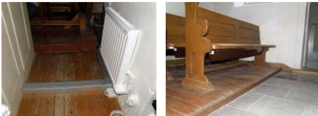
Vita radiatorer monterades på väggarna eller stående på golvet. I bänkarna monterades nya bänkvärmare.
