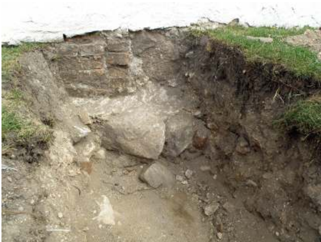
Vid schaktning för elkabeln blev grundläggning och murverk till trappinbyggnaden synligt. Tegelmurningen tolkades som en äldre igensättning, möjligen en igenmurad dörröppning.
