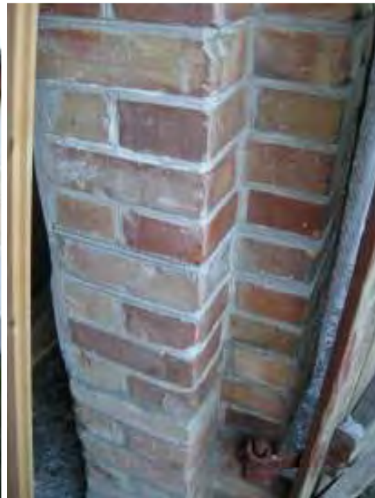
Tegelomfattningar vid norra porten, väst fasaden. Det gulaktiga teglet är det utbytt. Notera även pärlfogen i ovankant och slätfogen längre ner.
