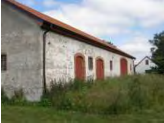
Den östra fasaden innan åtgärderna.
