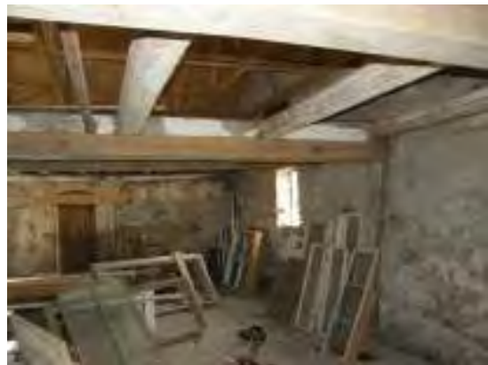
Ekonomibyggnaden invändigt före åtgärderna...
