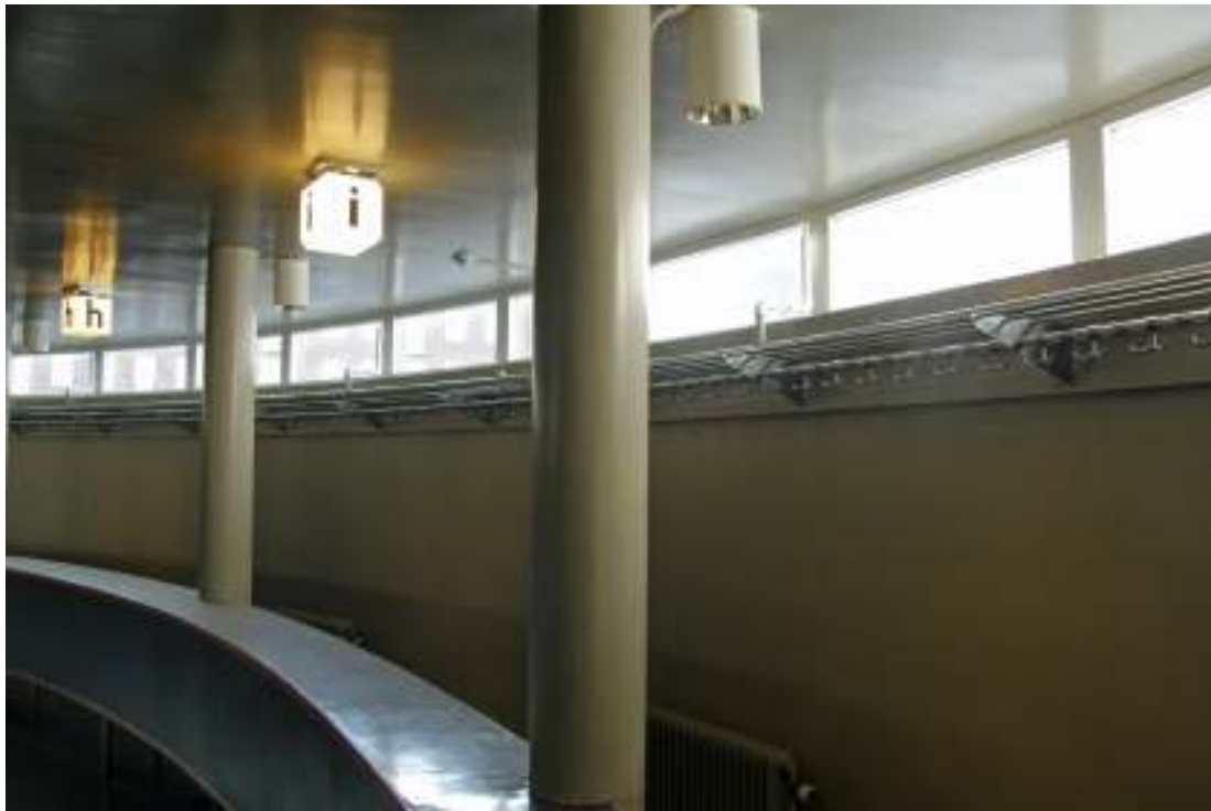
Södra garderoben med sprinkler.
