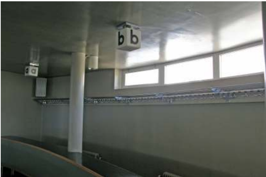
Södra garderoben, utan sprinkler.
