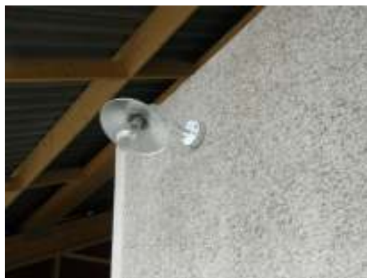
Väggarmatur på den nordöstra fasaden.
