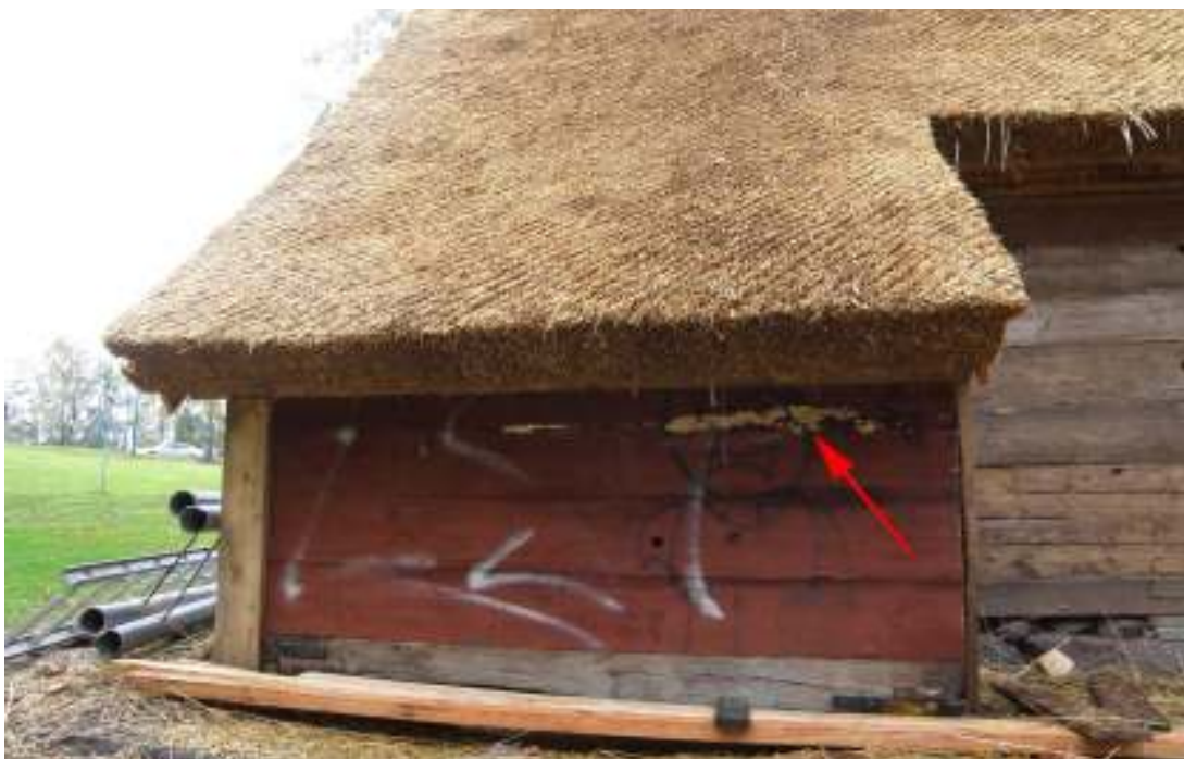
Fig. 8. Svampangreppet på Svinhusets östra vägg.
