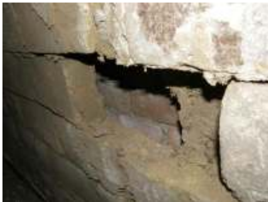
Stor glipa mellan inner- och ytterväggen.
