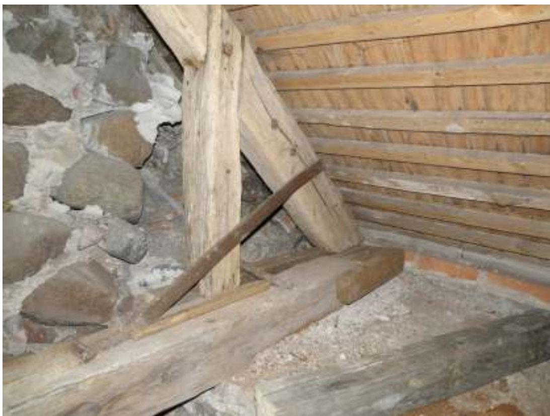
Takstolen lagades med nytt virke i bjälkänden vid takfoten och nytt virke på bortsidan av bjälken som också stöder stödbenet vars nedre del var upprutten. Järnbandet utgör en äldre förstärkning.
