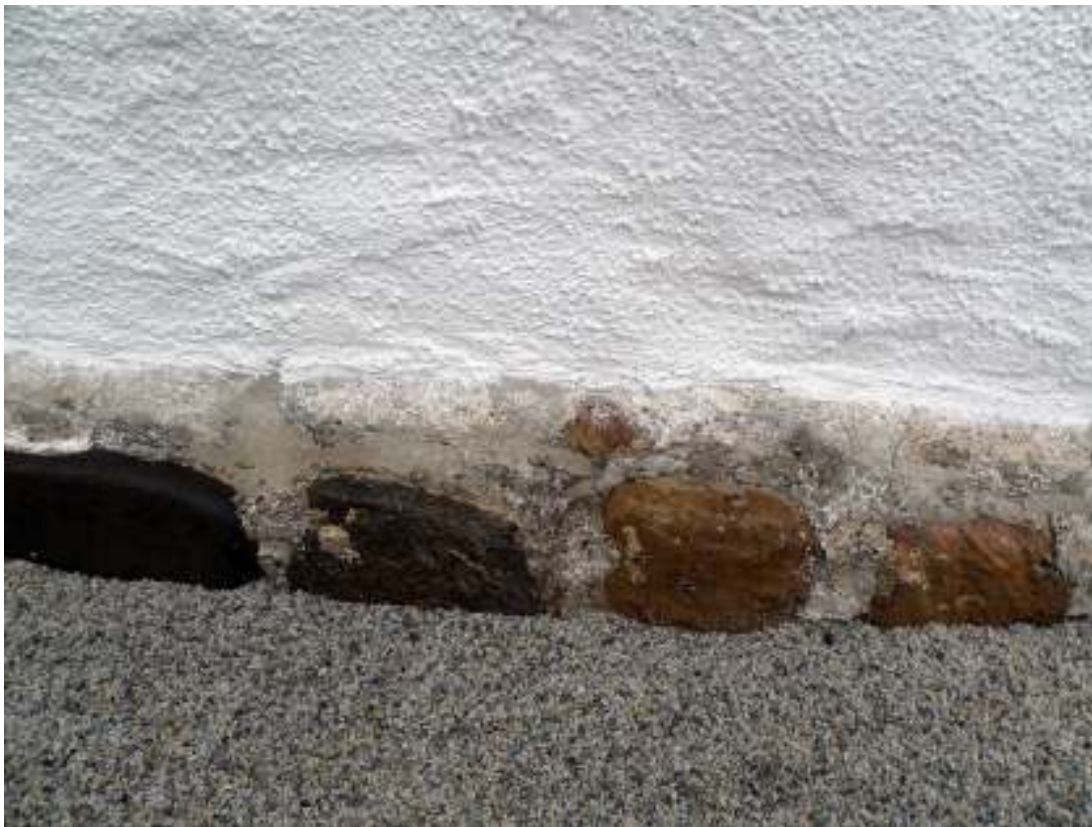
Tornets sockel hade varit överputsad med ett starkt ke-bruk. Löst bruk togs bort i övrigt putsades inte sockeln över utan foglagades endast och brukstättades mellan stenen.
