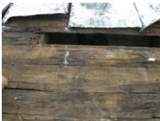
Rötskadad underbrädning. Notera isfläckarna.
