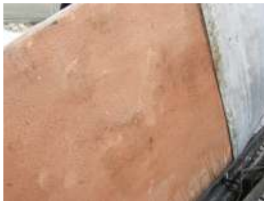
Undersidan av den bortplockade plåten.
