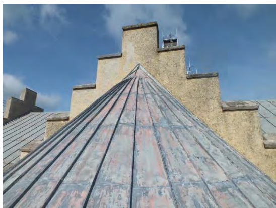
Både kyrkans fasad och plåtdelar var i behov av underhåll.
