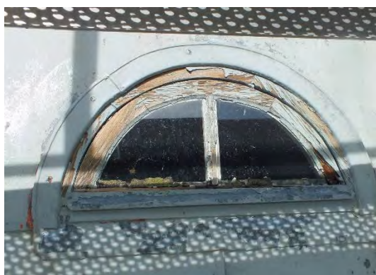
Fönstret på tornet hade skadats av vatten som runnit på ramen. Ett extra fönsterbleck lades till för att minska problemen med vattnet.
