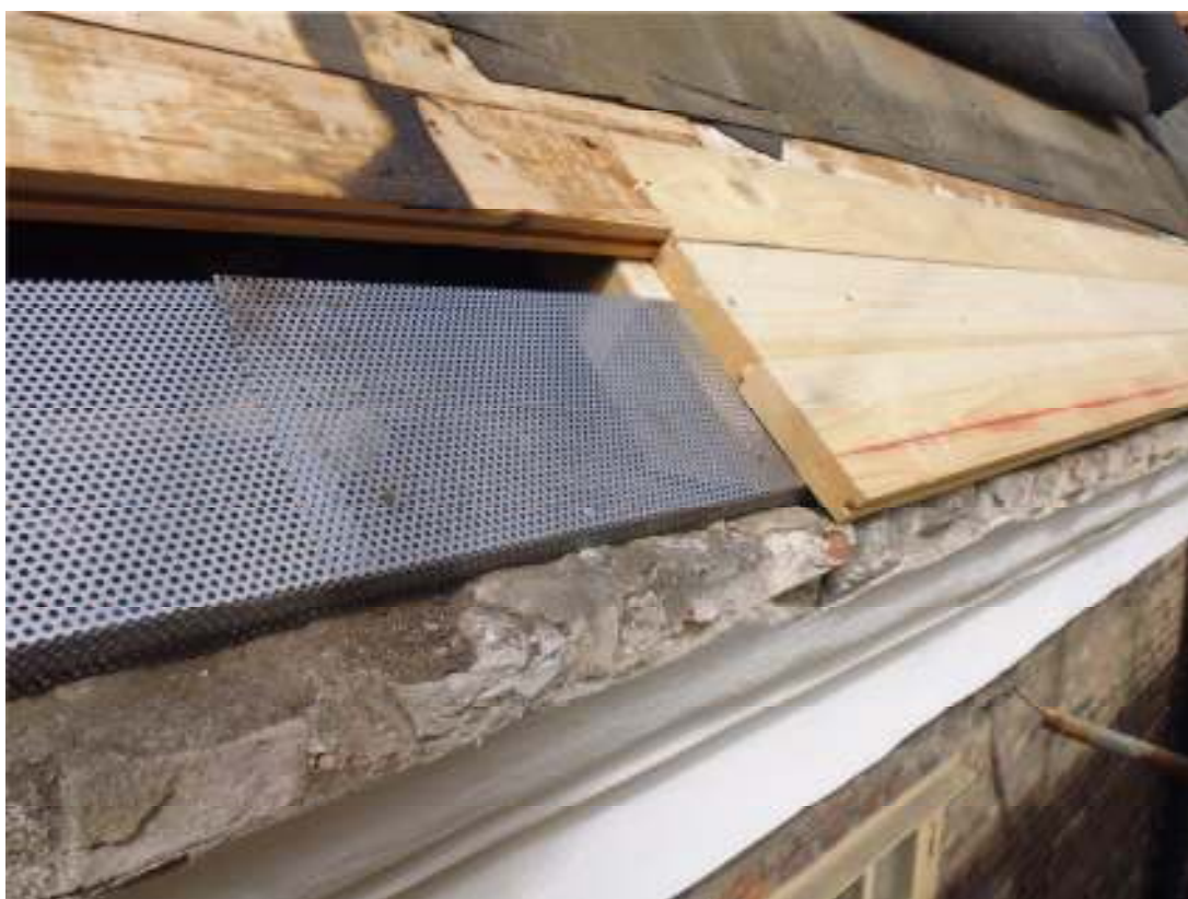
Fig. 7. Hålplåten. Luft kan passera mellan gesimsen och nedersta brädan och därefter genom hålplåten, vars syfte är att hindra större insekter och yrsnö från att komma in under takfoten.
