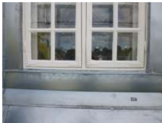
Fig. 9. Exempel på renoverat fönster.
