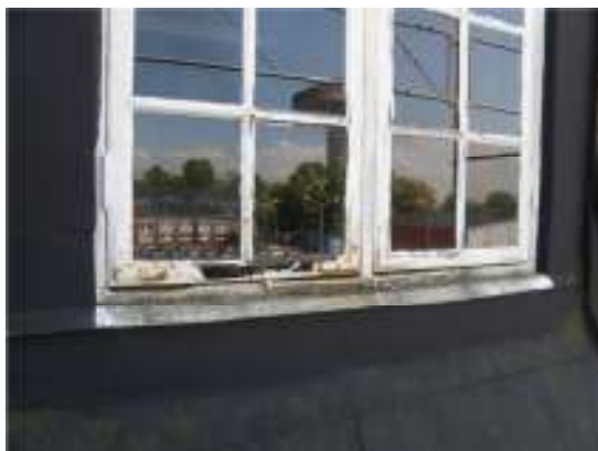
Fig. 8. Skadat fönster innan arbetet.
