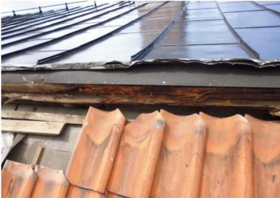
Fig. 13. Rötskadad figurhyvlat timmer på mansardtaksvinkeln.
