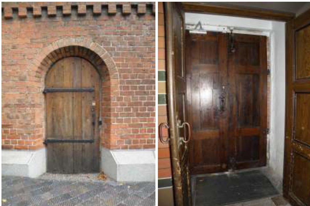
Bild till vänster: Äldre ingång till pannrummet som inte används längre, före ombyggnaden.
