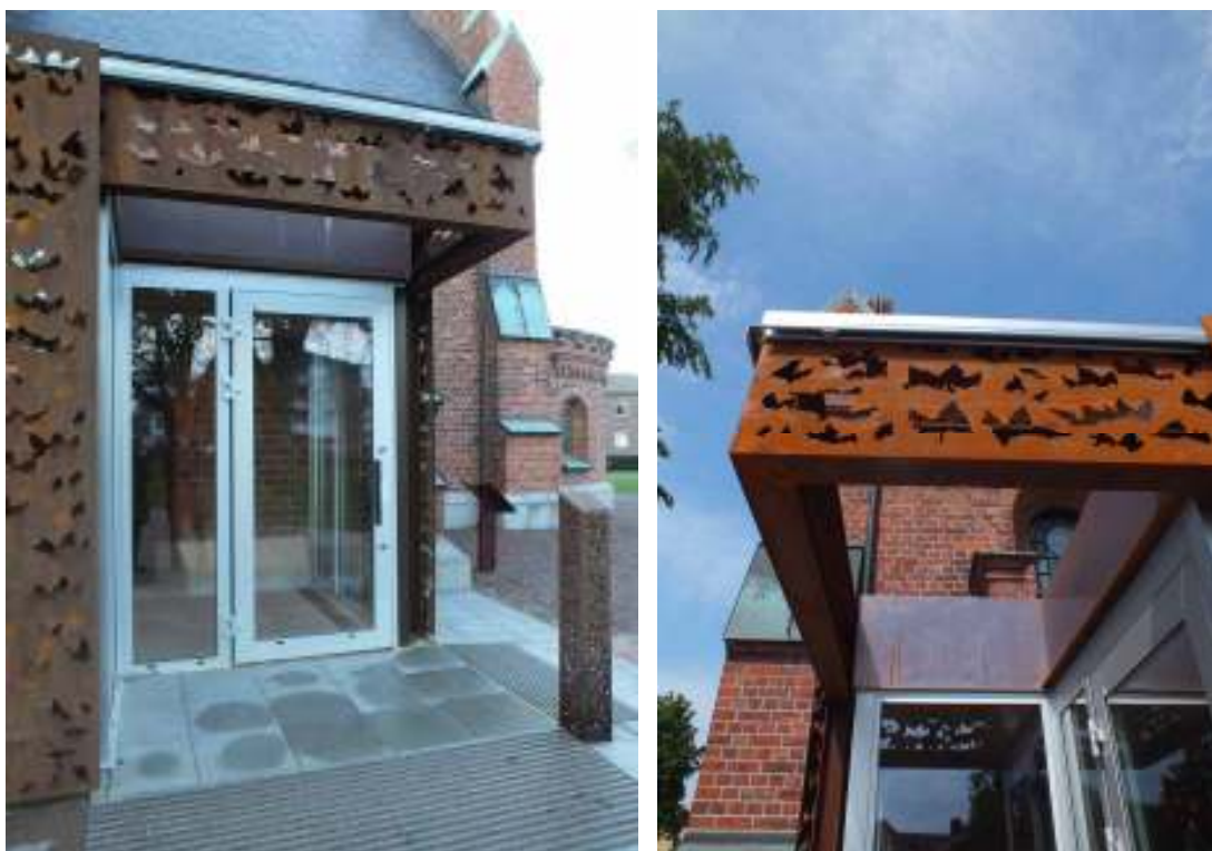
Den nya entrebyggnaden har ett indraget dörrparti och ett utskjutande parti av corténstål var ursprungligen tänkt att ha ett tak av glas vilket inte monterades.
