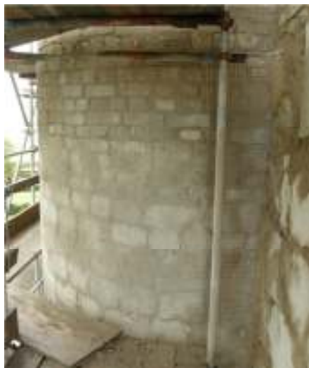
På muren vid torntrapporna användes nät som underlag till putsen i syfte att förhindra nya skador och sprickbildningar.
