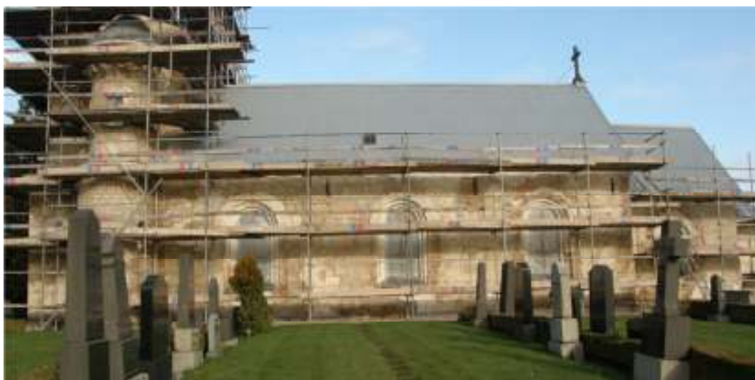
Kyrkans södra fasad under renoveringen. Större delen av putsen var i sådant skick att den behövde ersättas med ny puts. Plättäckningen på långhuset och absiden var däremot i bra skick och kunde därför bevaras.
