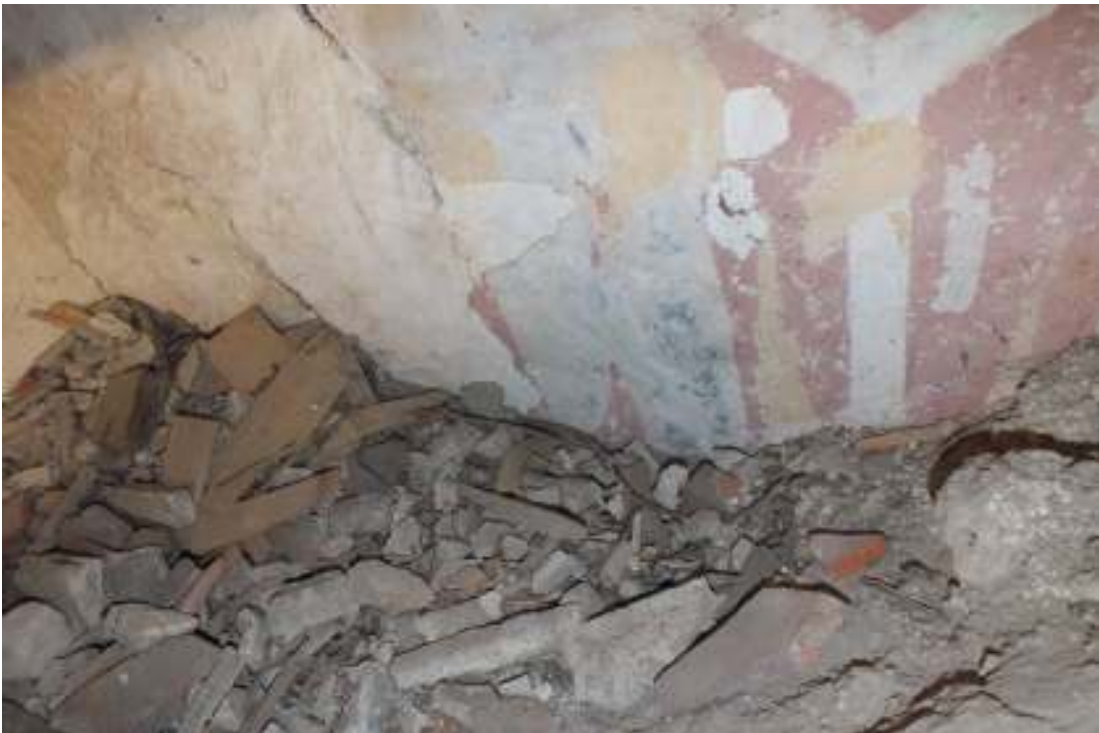
Löst sittande romansk kalkmålning och byggskräp på långhusvind.
