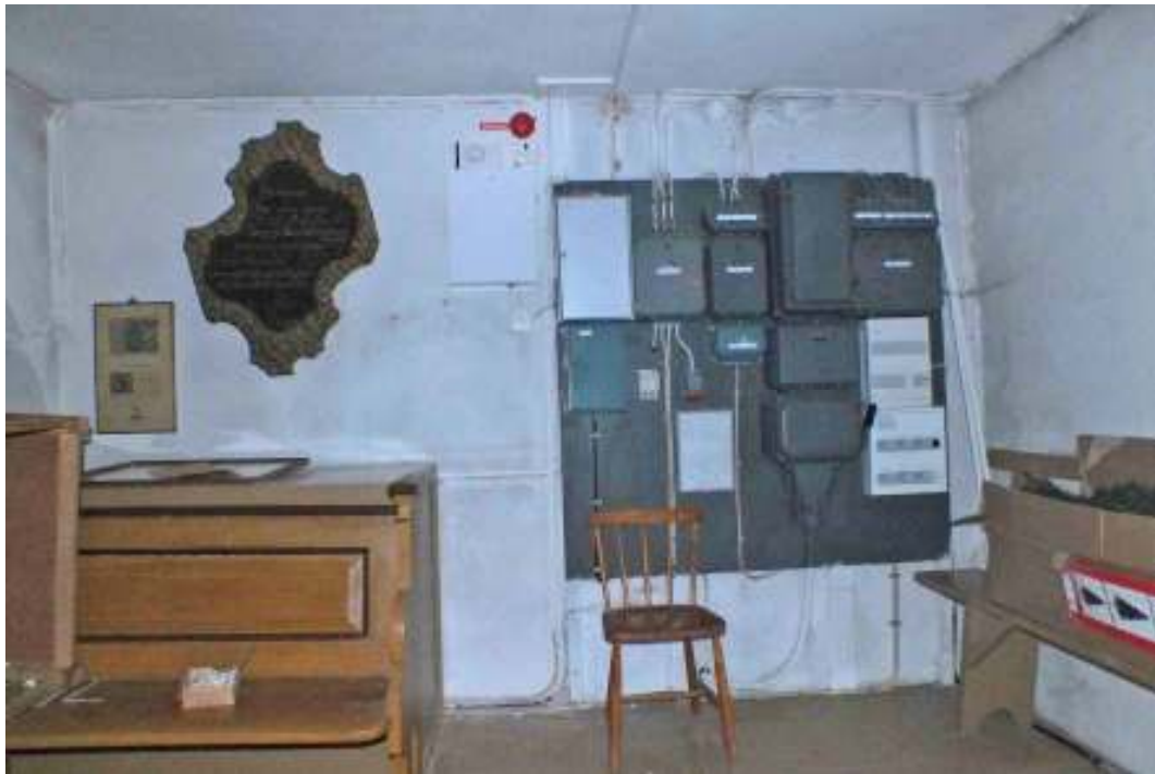
Kyrkans elcentral innan arbetena.
