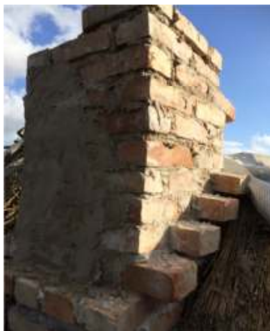
Skorstenens utkragade vattenavrinningsstenar.
