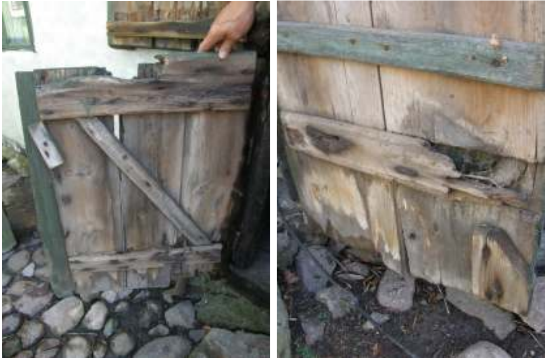
Den mellersta bryggbusporten var i väldigt dåligt skick, t v det vänstra nedre dörrbladet och t h detalj av det högra. Det vänstra nedre dörrbladet byttes, se nedan, och det högra lagades med en ny tvärslå.
