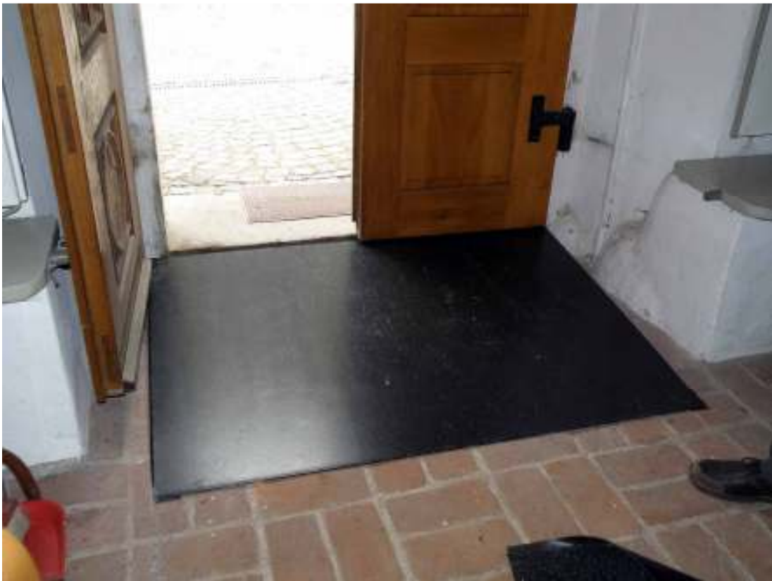
Innanför ytterdörren lades en ramp av plåt vilken täcktes med en gummimatta.
