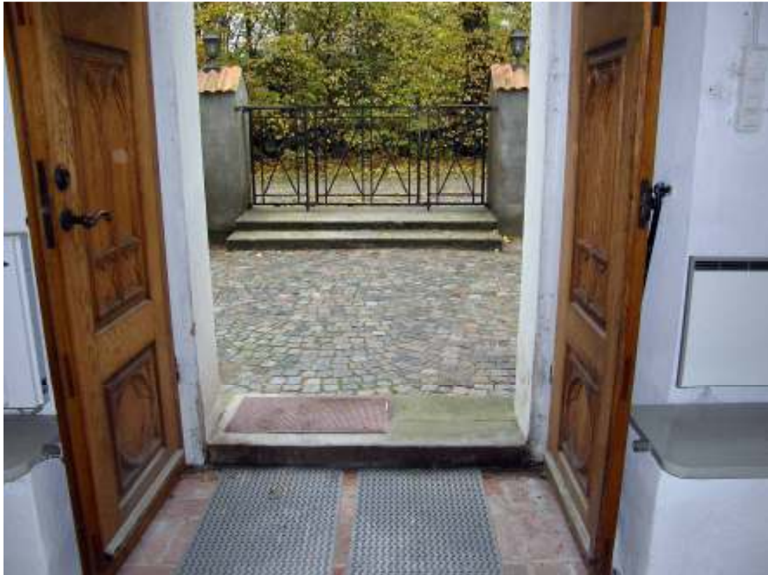
Entrén före arbetets början sedd från vapenhuset mot väster. En hög tröskel fanns invändigt med anslag för dörren på cirka 7 cm. I grindöppningen fanns två trappstenar innanför grinden och en nivåskillnad mellan den övre trappstenen och den yttre marknivån.
