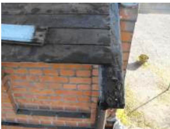
Rötskadad takfotskonsol i sydvästra hörnet.
