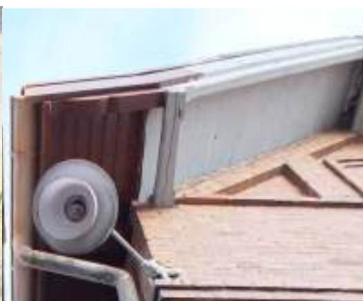
Samma börn som åtgärdats om målat i brun kulör.
