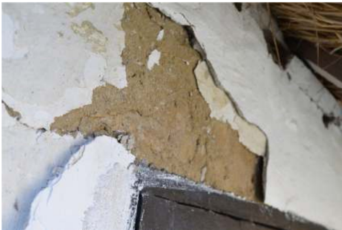
Fig. 5. Skada på boningshuset (sprucken sentida cementputs).
