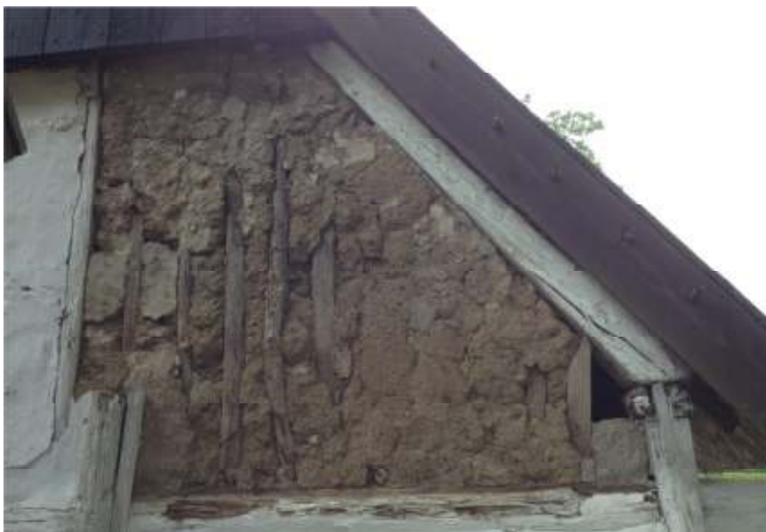
Fig. 6. Östra längans södra gavelröste, cementputsen borttagen.
