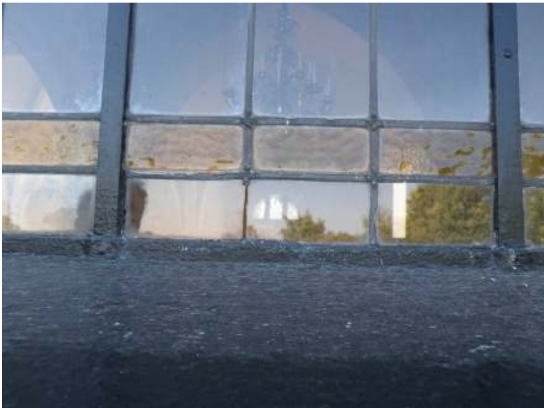
Kyrkans fönster bedömdes inte vara i akut behov av åtgärd. En renovering av fönstret behöver dock planeras in snarast.
