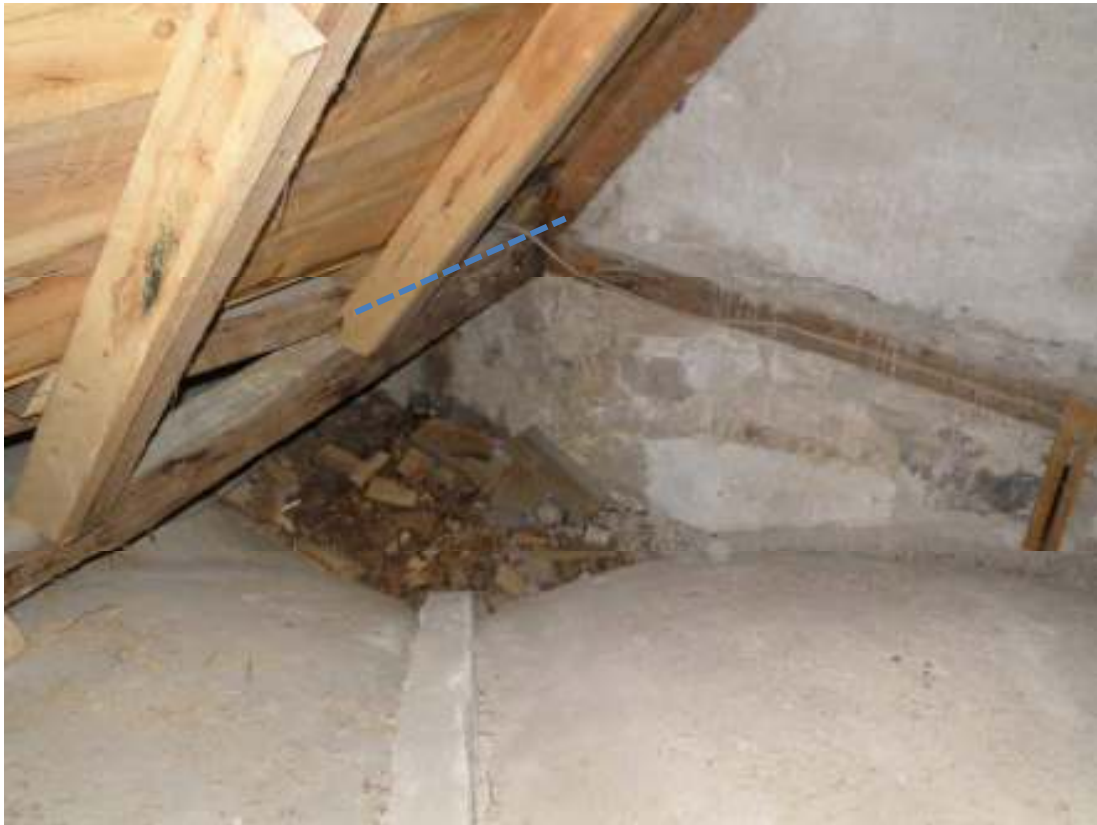
Streckat parti markerar var den rötskadade bjälken har lagats med nytt virke. Bjälken är belägen under ränn dalen mellan tvärskeppets östra och västra takfall. Bilden visar bjälkändan från väster.
