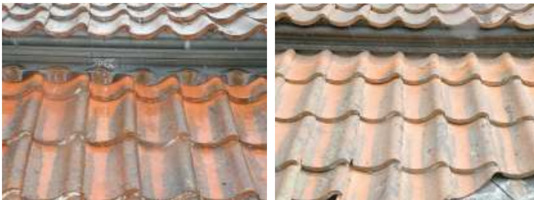
På den vänstra bilden syns plåten som täcker brottet mellan över- och undre takfallet. Notera att det finns ett hål nedanför varje panna där regnet träffat plåten. På den högra bilden har plåten klippts av och den nedre delen tagits bort.
