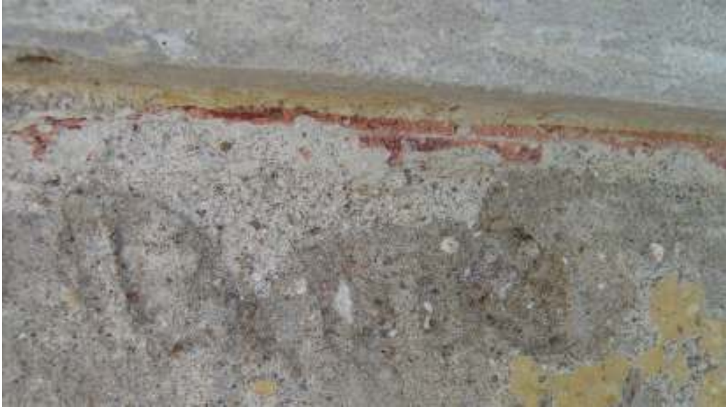
Äldre rosaröd avfärgning framkom vid rengöring i anslutning till takfotsgesimsen utmed den västra fasaden.
