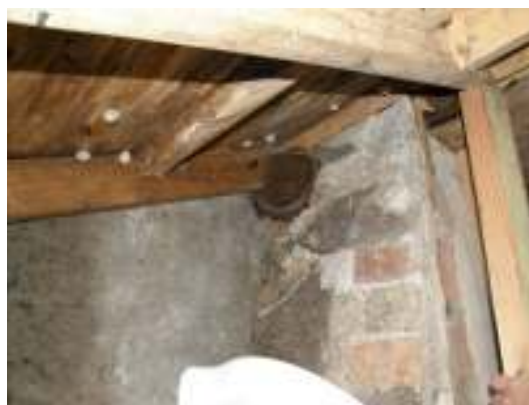
Fig. 10. Ventilationsröret i källarnedgången.
