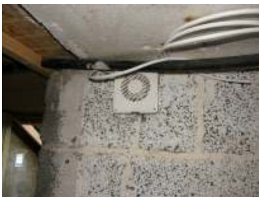
Fig. 9. Paxfläkten på norra cellväggen.
