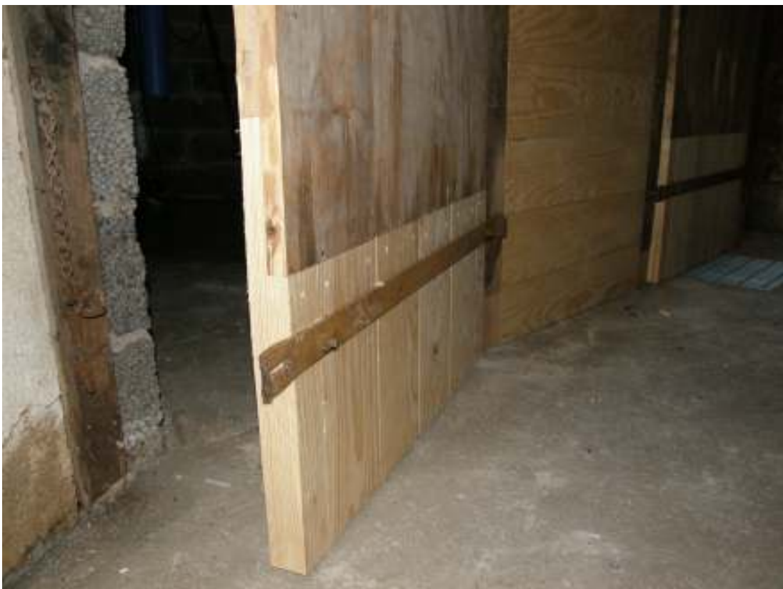
Fig. 13. Norra dörrens lagning.
