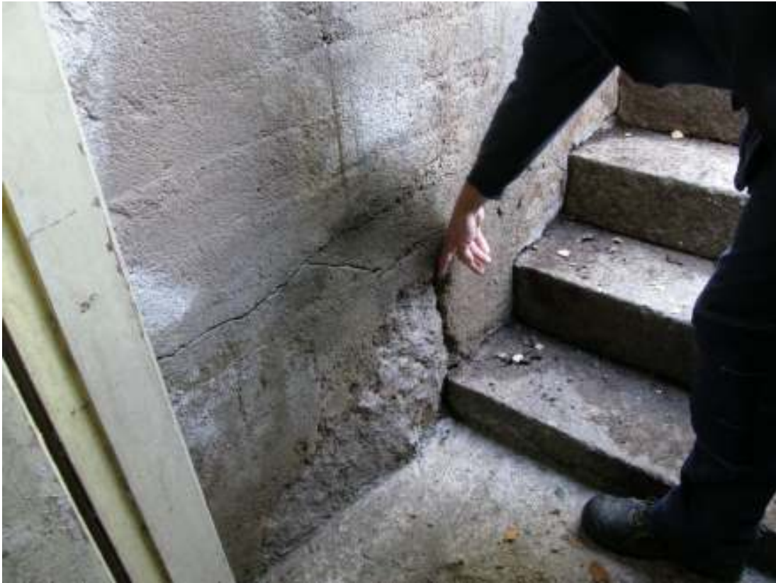
Fig. 14. Spricka i västra vangstycket, varur regnvatten tränger ner till källaren.
