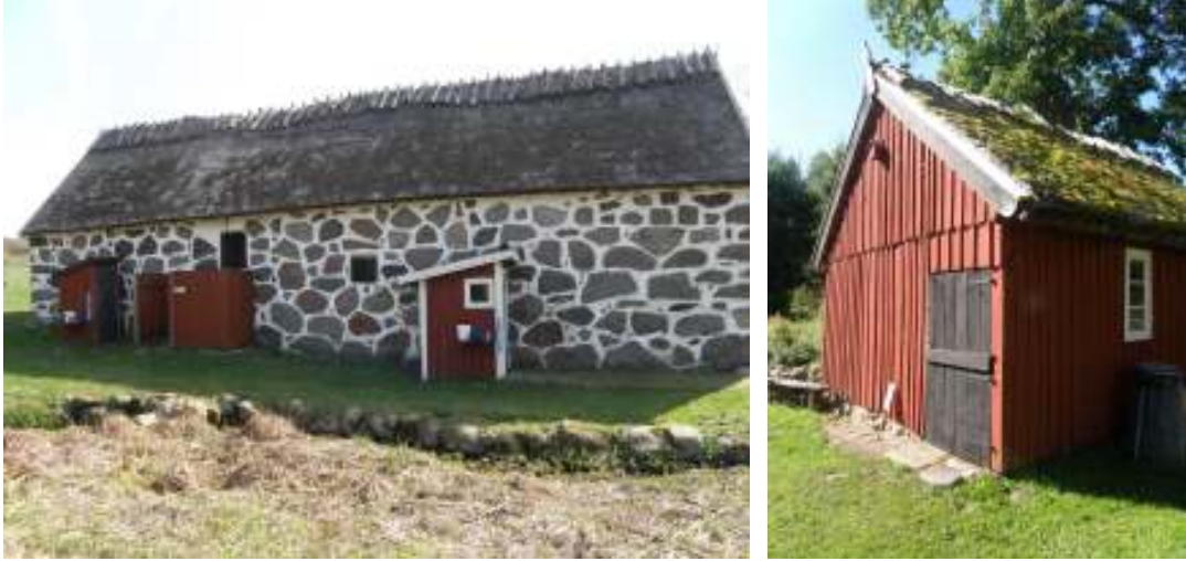
Bilden visar den västra längans takfall åt väster innan omläggning av ett sti. På den högra bilden ses svinbuset med ny solbräda åt nordost.
