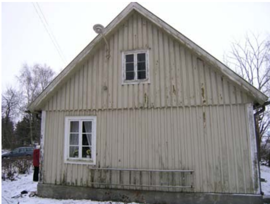
Norra fotograferad i slutet av januari 2010. Denna fasad var värst drabbad av skador.
