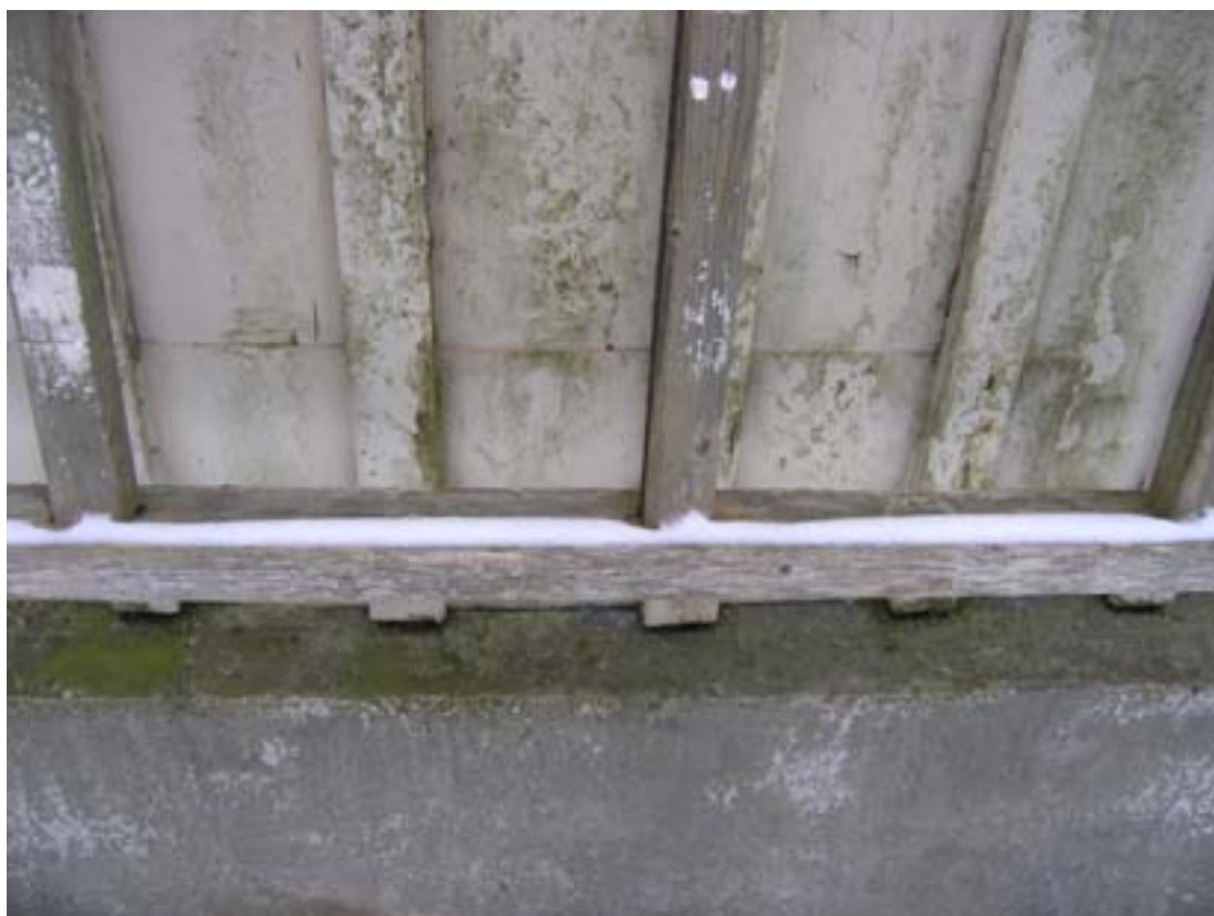
Detalj av norra gavelns nedre panel. Den rötskadade panelen var ersatt av en skiva med påspikad locklist.
