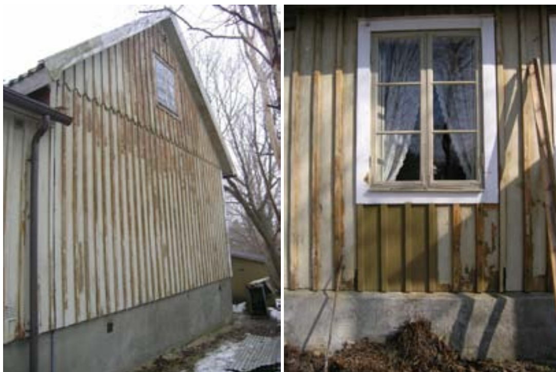
Till vänster västra gaveln av den tillbyggda skolsalen efter avslutad färgskrapning. Till vänster provstryknin av panelen med äkta linoljefärg pigmenterad med obränd terra.
