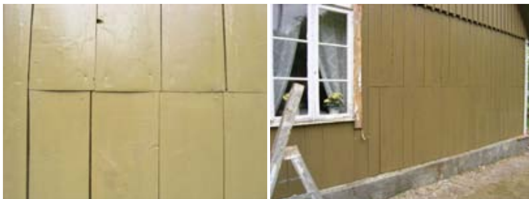
Till vänster detalj av den iskarvade och nymålade panelen på norra gaveln. Till höger samma gavel, där man kan se att panelbräderna har kapats olika högt beroende på skadebild och möjligheter till infästning i korsvirket innanför.
