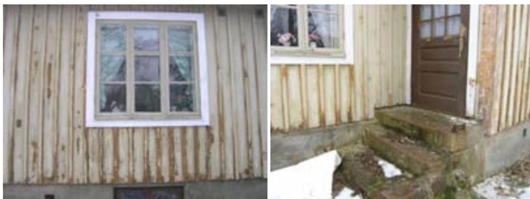
Till vänster detalj av panelen på västra fasaden. Till höger västra fasaden intill köksingången. Panelen har skrapats och fönstren av grundmålat, då entreprenören i samråd med Regionmuseet bedömde att fönstren annars kunde skadas innan de ska göras vid och målas om år 2011.
