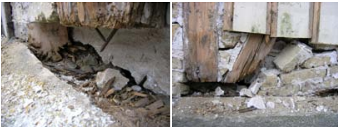
Till vänster detalj av den rötskadade syllen liksom det dike som bildades när den gjutna sockeln lades utanpå befintlig murad sockel av natursten. Till höger ett av de fack som befanns skadade och fick muras om.
