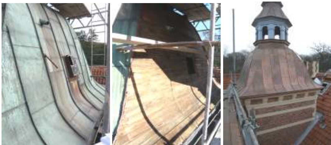
Bilderna visar det östra tornet med befintlig plåttäckning, underbrädningen sedan plåten avlägsnats och sist den nya plåttäckningen.
