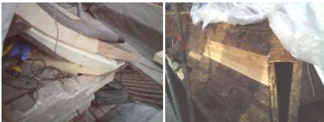
Bilderna visar den del av de lagningar som har utförts på det västra torntaket. Bilderna är tagna av Måleriforma Rose Bergström och son.
