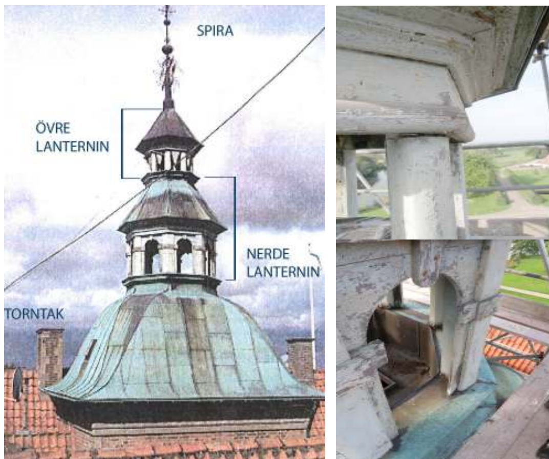
Vänster: Orienteringsbild som visar hur tornens övre delar ser ut med övre och undre lanternin samt tornetak, foto Niclas Hansson, Ramböll. Höger: Övre bilden är en detaljbild av övre lanterninens snickerier och den undre bilden visar snickerierna på den undre lanterninen.
