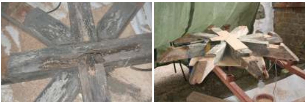
Ett av stjärnbjälklagen med en rötskada i mitten där spiran varit fäst. På den högra bilden pågår mättagning inför nyttillverkning av ett av bjälklagen. Bilderna är tagna av Måleriforma Rose Bergström och son.
