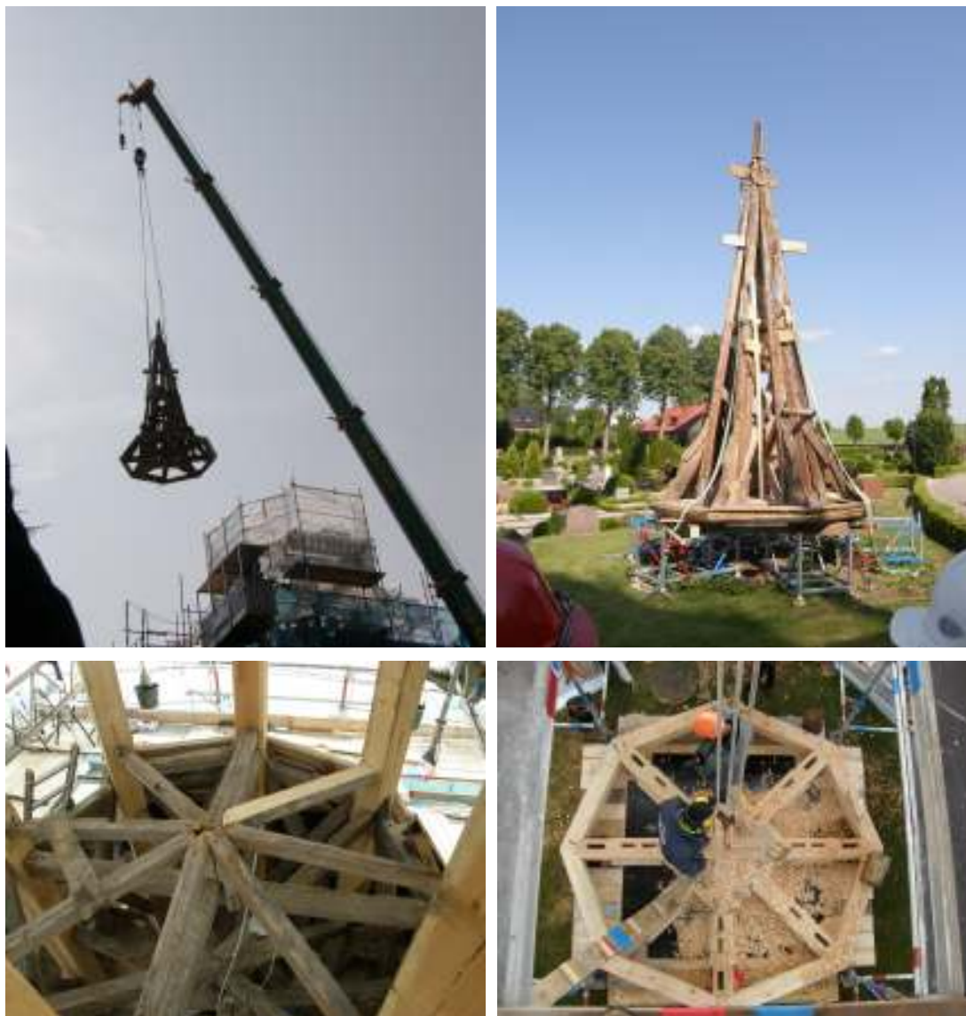
Tornspiran över lanterninen lyftes ned från tornet och nytillverkades i sin helhet. Lanterninens åtta stolpar ersattes med nytt virke och sammanfogades med äldre delar av stommen (bild ovan till vänster). Bilden nedan till höger visar spirans nedre ramverk.
