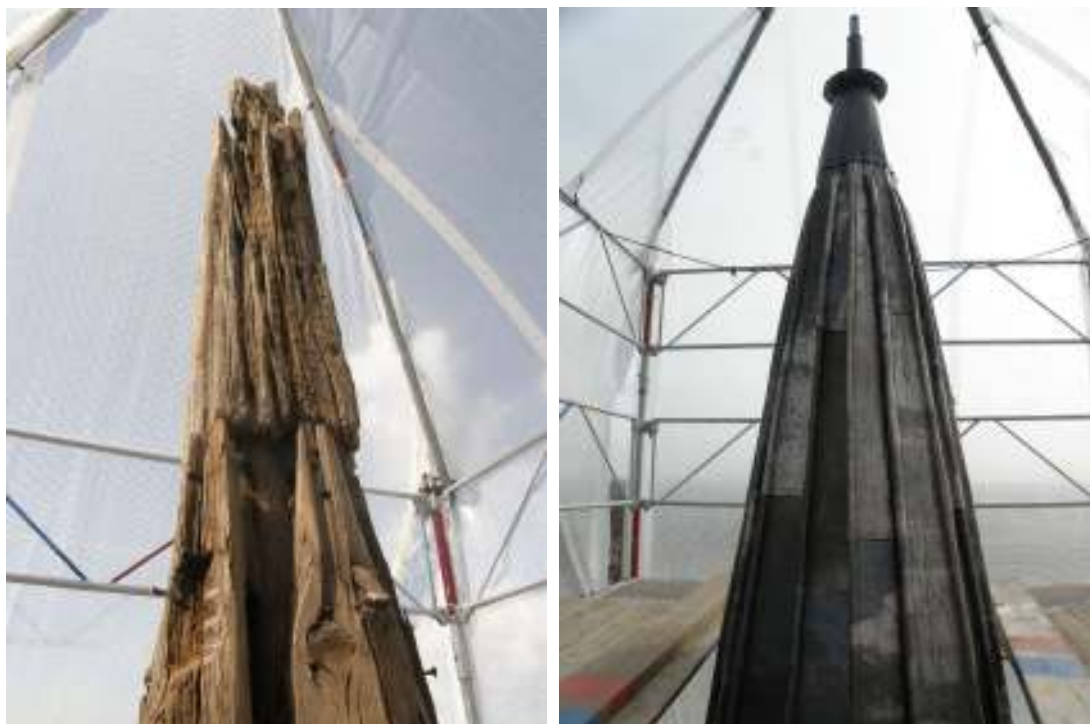
Bilden till vänster visar den rötskadade spirspetsen. Till höger syns den blytäckta spirspetsen efter renovering 2010.
