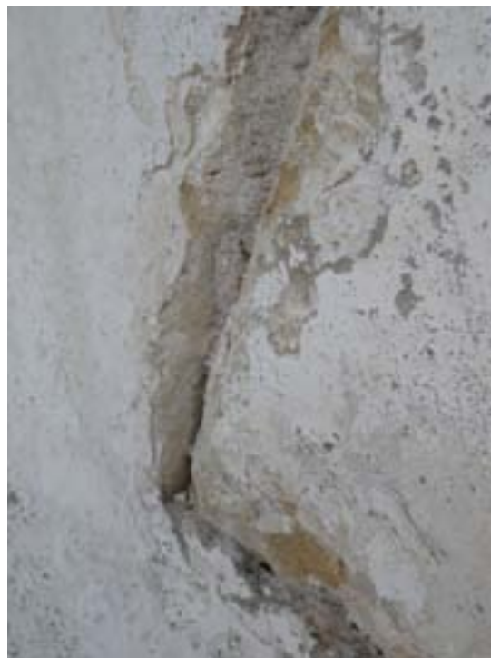
Spricka i norra långhusväggen vid romansk fönsteröppning
