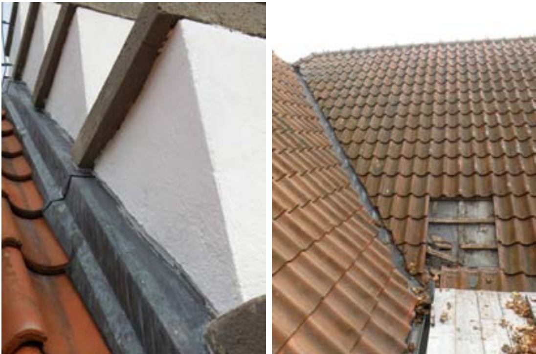
Silikonfog vid anslutningen mellan långhustaket och tornets östra fasad Rötskadan vid vinkelrännan på korsarmens sydvästsida
