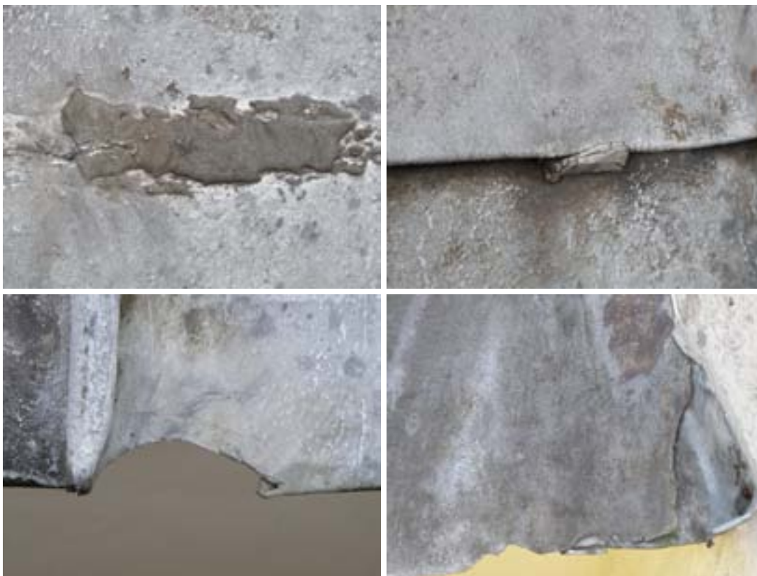
Absidens blytak innan renoveringen; Gammal lagning, mot söder En bit bortklippt takplåt
