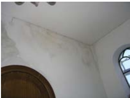
Fuktskadan i före detta bisättningsrummet
