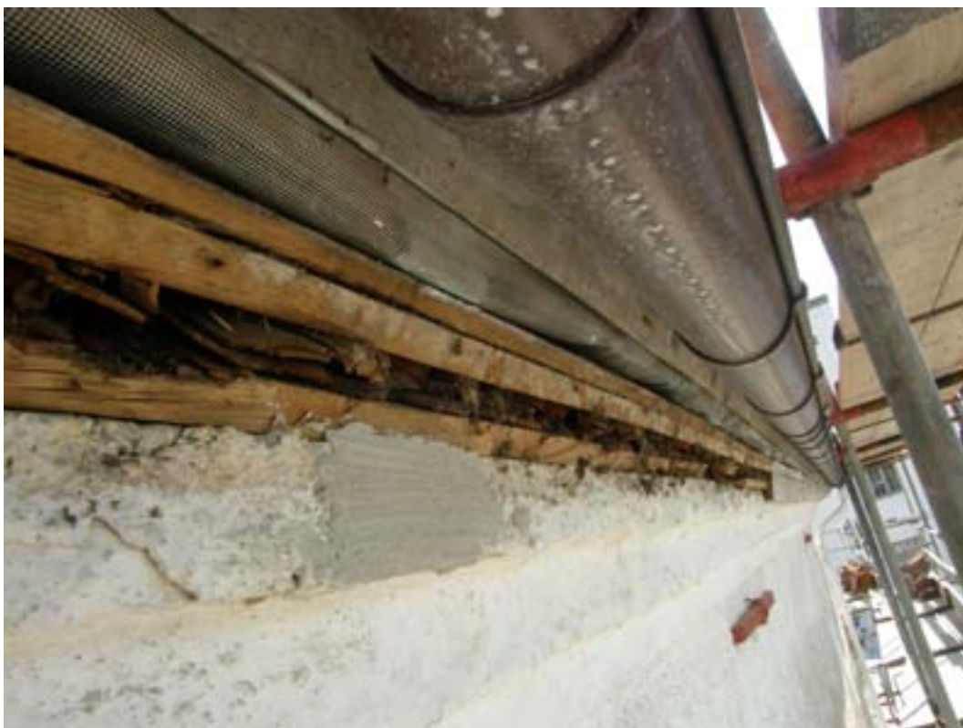
Bild 18. På långhusets södra sida byttes delar av takfotsbrädorna. Under undertaket syns stickespånen från ett äldre tak.
