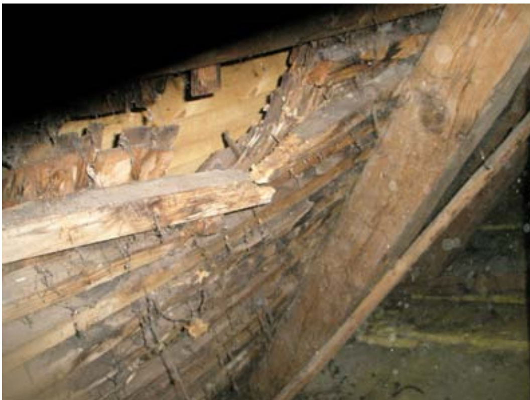
Bild 17. Rötskadat parti av innertaket på korets södra sida.
