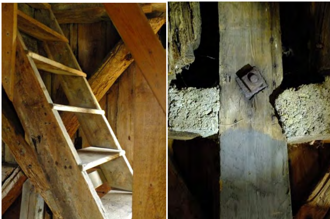
Den invändiga, ursprungliga panelen syns på bilden till vänster. På bilden till höger ser man en sentida speciallösning av cement som gjorts i ett försök av att stödja konstruktionen.
