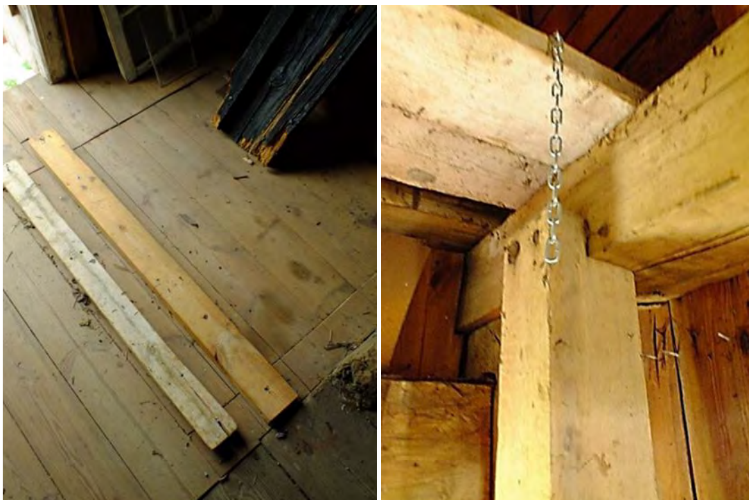
Till vänster en provisoriskt åtgärdad golvlucka genom vilken vandalerna tog sig in i möllan. Till höger vittnar ännu den avslitna kättingen, tillhörande bromsen, om vandalernas framfart.
