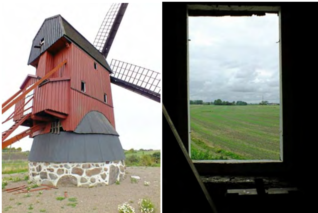
På bilden till vänster syns hålet i panelen där vandalerna tog sig in. Möllans fönster hade kastats ut. Glas, bågar och spröjsar var förstörda. Allt låg strött runt om möllan.
